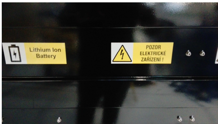
Obrázek 55: Detailní provedení nápisů na skříních trakčních baterií - lit. [41]
