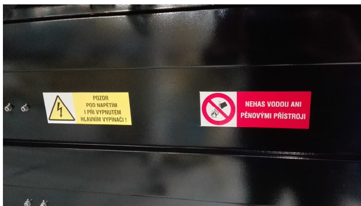
Obrázek 56: Detailní provedení nápisů na skříních trakčních baterií - lit. [41]
